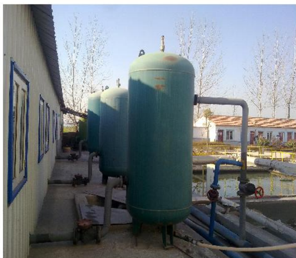
充填站空压机房
