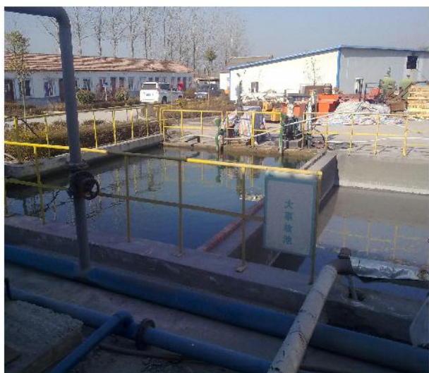
充填站事故池
