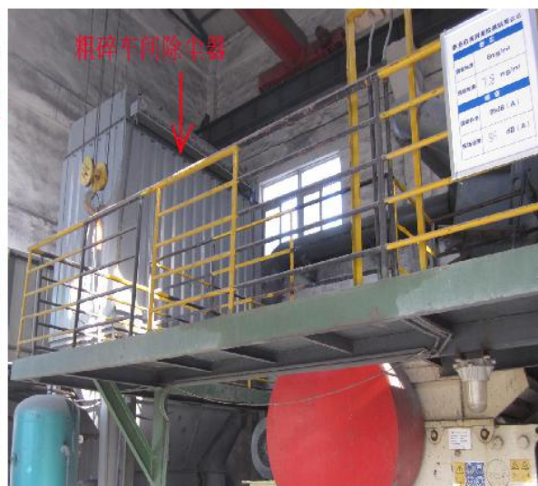
粗碎车间袋式除尘器
