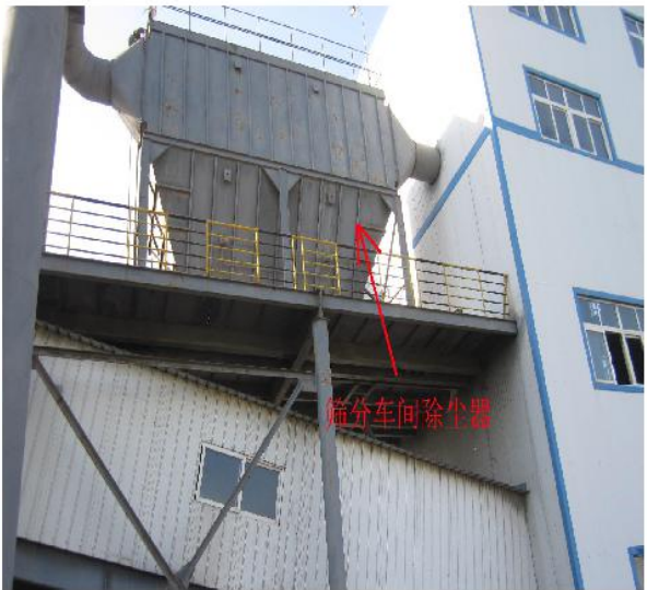
筛分车间袋式除尘器
