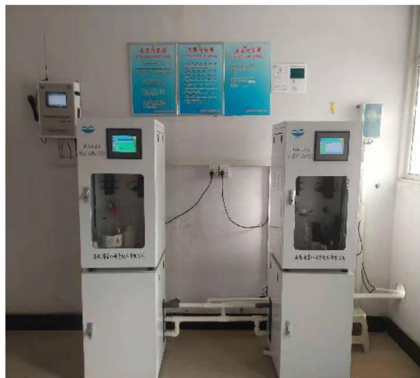
废水在线监控设施
